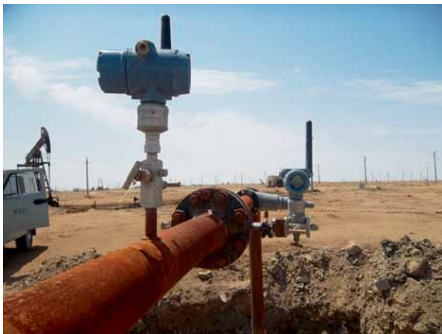
Рис. 1. Датчик давления Rosemount 3051S и расходомер на базе стабилизирующей диафрагмы, установленные на трубопроводе нагнетательной скважины
