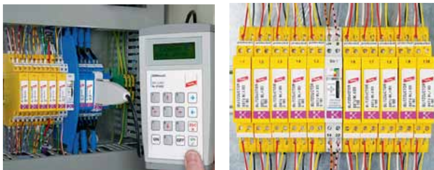
Рис. 2. Слева – переносной тестер DRC LC M3+; справа – стационарный блок мониторинга DRC MCM XT, позволяющий контролировать состояние до 10 сменных модулей УЗИП BLITZDUCTOR XT
