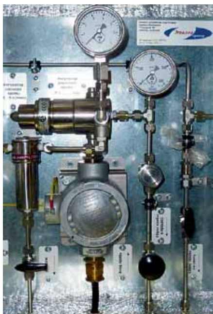
▲ Узел фильтрации и сброса давления
