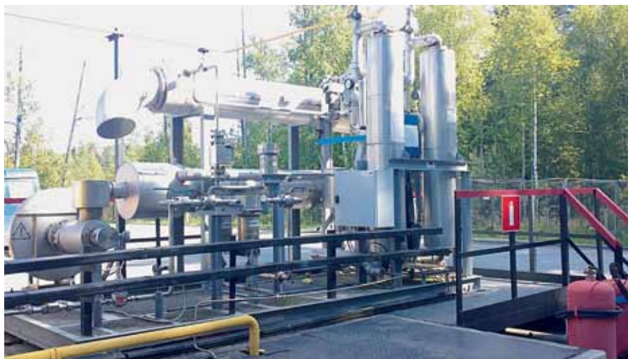
▲ Автомобильная газонаполнительная компрессорная станция
