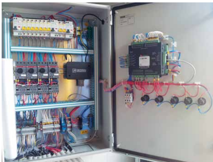
Рис. 3. Навесной шкаф с системой автоматизации модульной котельной: расположение компонентов внутри
