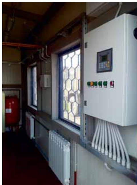
Рис. 5. Модуль котельной, установленный на объекте
