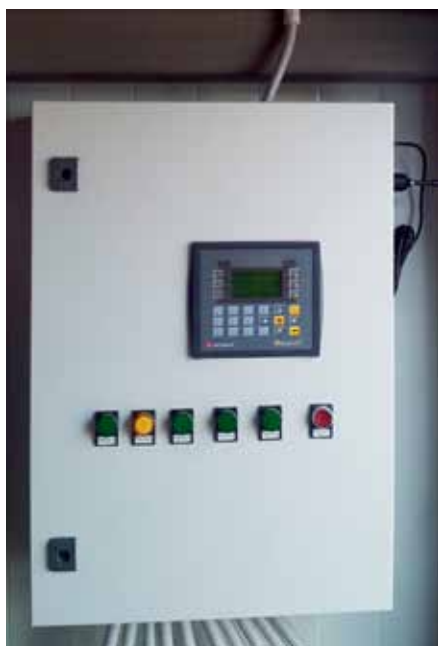
Рис. 2. Навесной шкаф с системой автоматизации модульной котельной: вид снаружи
