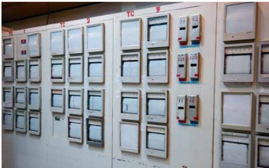
Рис. 2. Широкоизвестные приборы серии КС на щите управления паровым котлом
