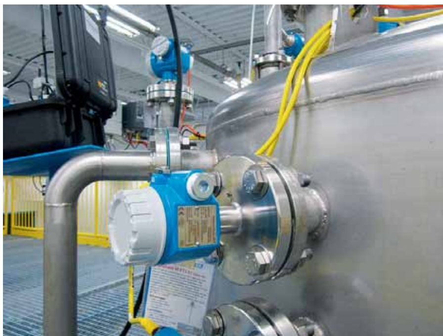
Рис. 2. Датчик предельного уровня, установленный в верхней части резервуара, предназначен для защиты от перелива
