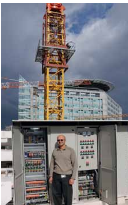
Рис. 2. Панель управления расположена на крыше больницы под жаркими солнечными лучами: это тоже своеобразная проверка для технологий PLC
