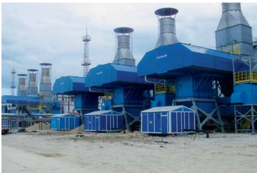
▲ Газотурбинная электростанция Талаканского месторождения ОАО «Сургутнефтегаз»
