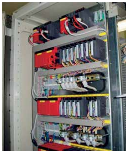
Рис. 3. Пример монтажа резервированной системы на основе сети MELSECNET/Н в едином шкафу
