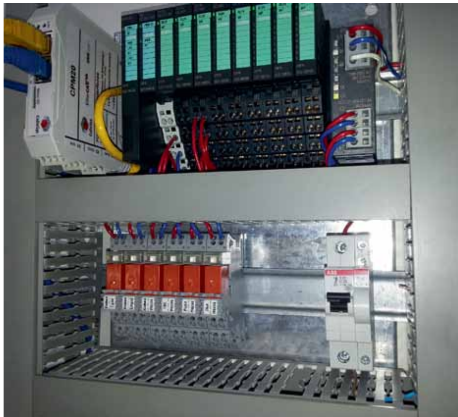
Рис. 3. Пример использования контроллера CPM20 в щите автоматики
