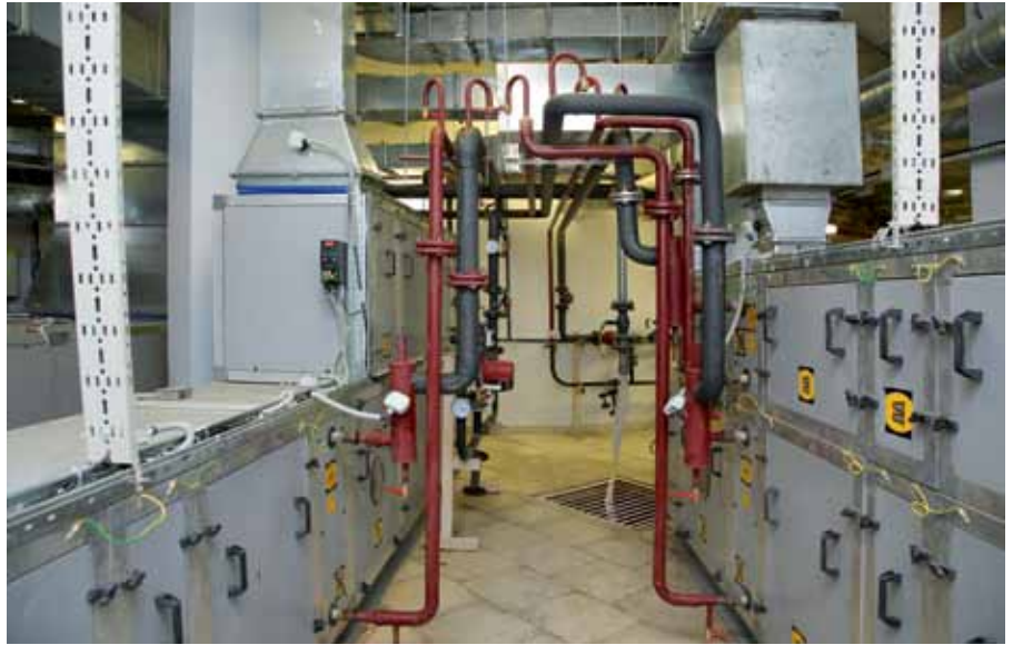
▲ Система приточно-вытяжной вентиляции и увлажнения воздуха
