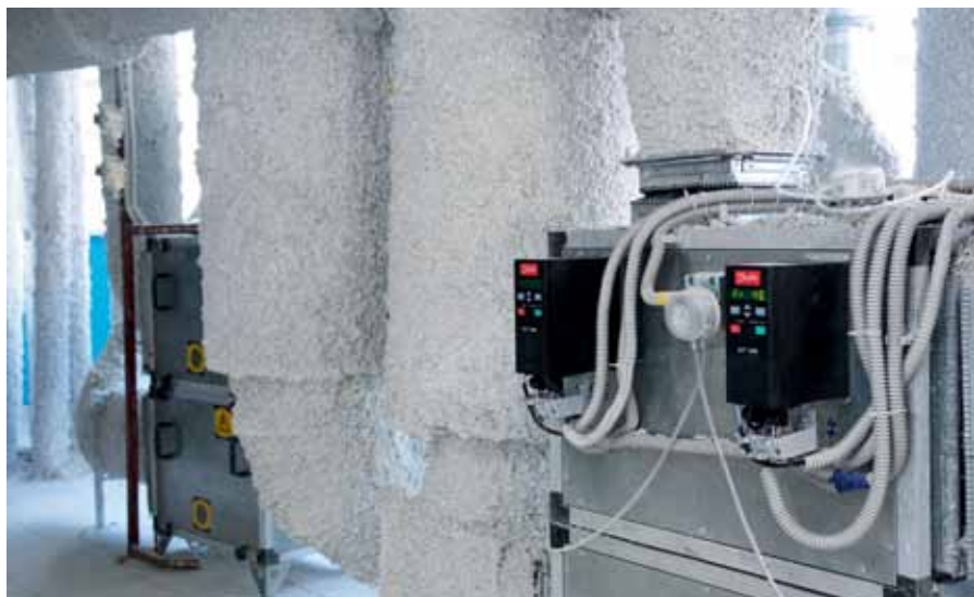
▲ Помещение с вытяжными системами
