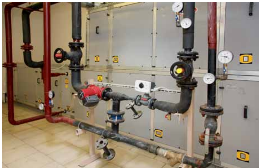
▲ Приточная система приточно-вытяжной вентиляции
