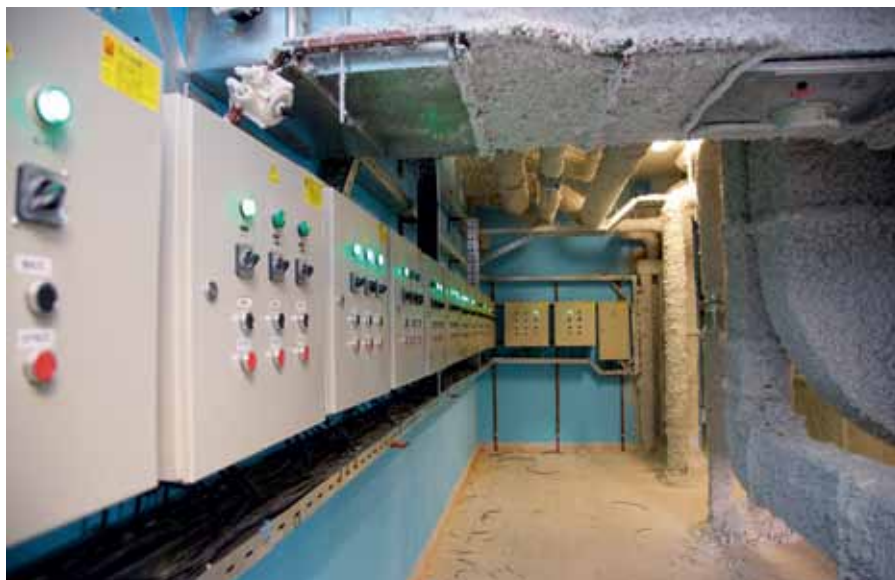
▲ Шкафы управления вытяжками системы приточно-вытяжной вентиляции
