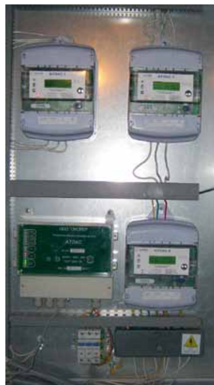
Рис. 7. Шкаф с оборудованием «АТЛАС» на вводном распределительном устройстве
