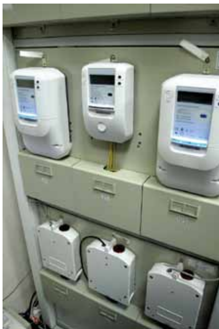
Рис. 3. «Умные» приборы учета, установленные компанией «Энергоаудитконтроль», с успехом работают в интеллектуальных сетях
