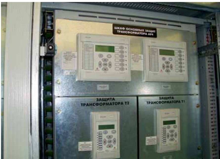
Рис. 1. Шкаф с микропроцессорными реле защиты MiCOM
