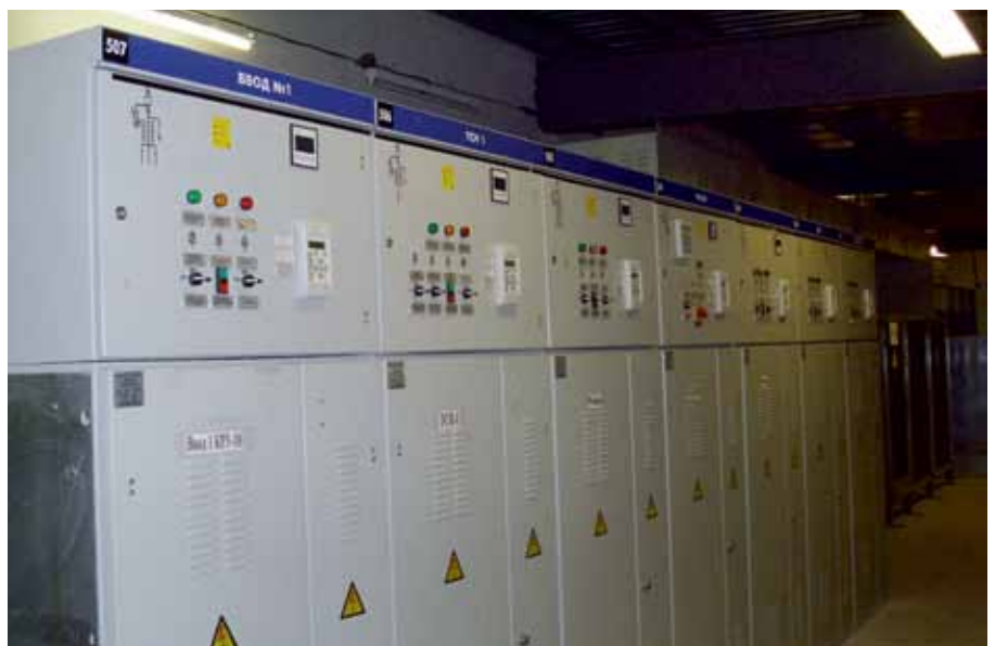
Рис. 3. Устройства токовой защиты одной подстанции
