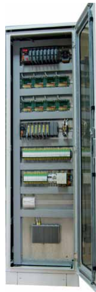
Рис. 5. Шкаф телемеханики и оперативной блокировки
