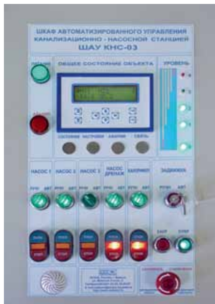
▲ Шкаф автоматизированного управления канализационной насосной станцией ШАУ КНС-03
