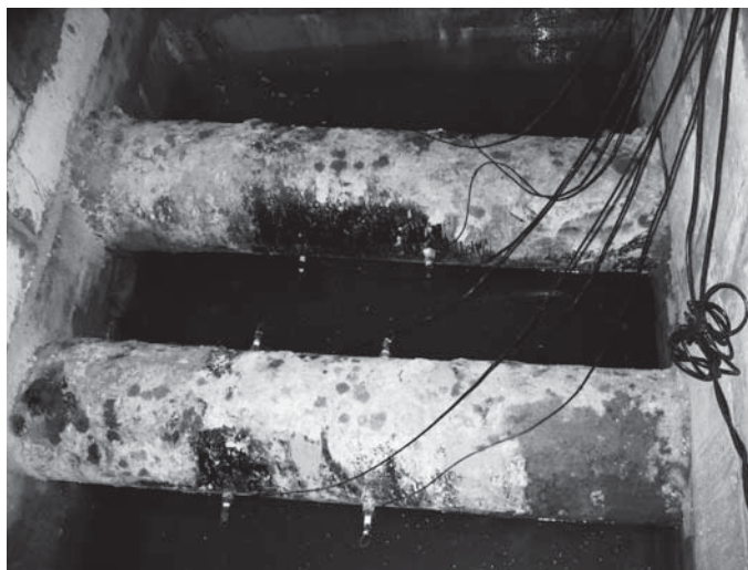
▲ Первичные преобразователи ультразвуковых корреляционных расходомеров, установленных на существующие трубопроводы без их демонтажа
