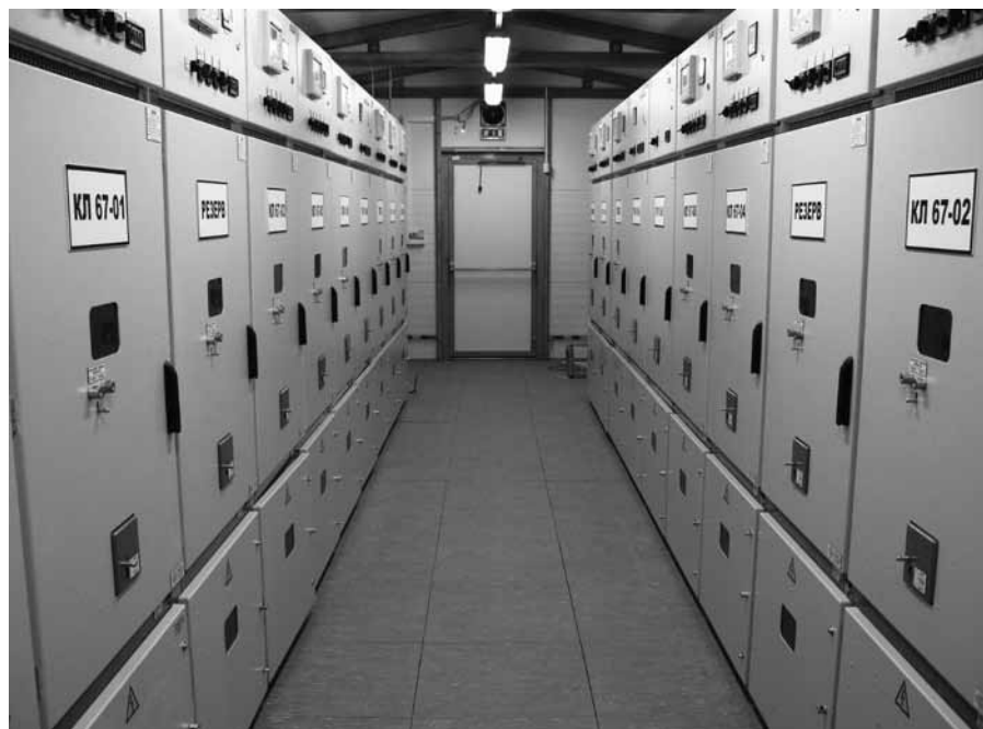
▲ Система мониторинга, контроля и управления электрическими подстанциями
