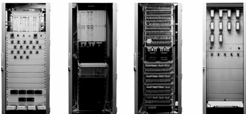
▲ Пример шкафов противоаварийного управления производства ЗАО «ИАЭС»
