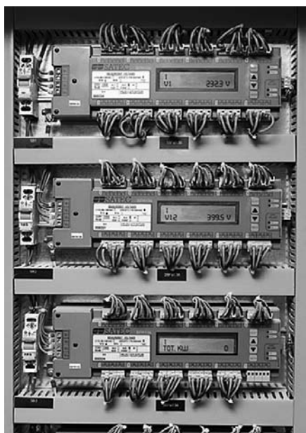
Рис. 2. Размещение многофидерного электросчетчика BFM136 при монтаже
