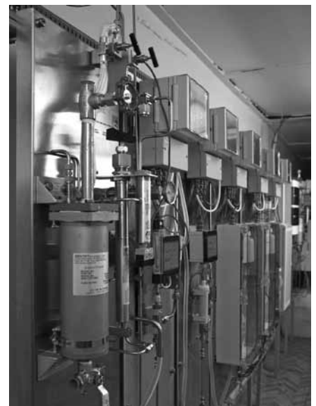
▲ Фрагмент системы АХК для Ленинградской АЭС
