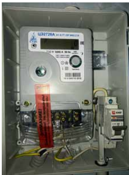
▲ Счетчик электроэнергии ЦЭ2726А с интерфейсом LoRaWAN
